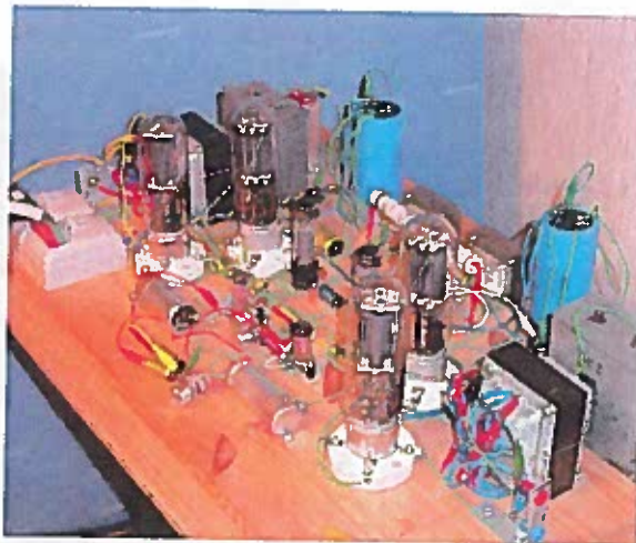
Bemærk de store komfurstik og kontakterne. Her er alting genbrug og mange kabler ligger frit tilgængelige med op til 2.000 volt. Absolut livsfarligt!
